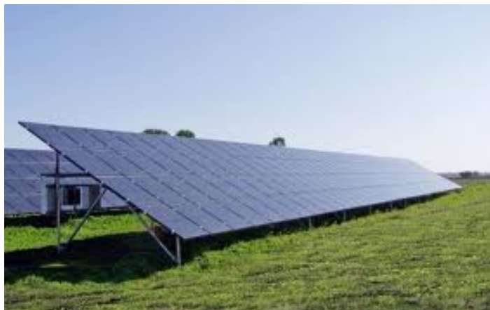
Impianto FV isolato
