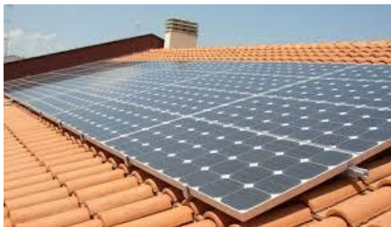
Impianto FV annesso
