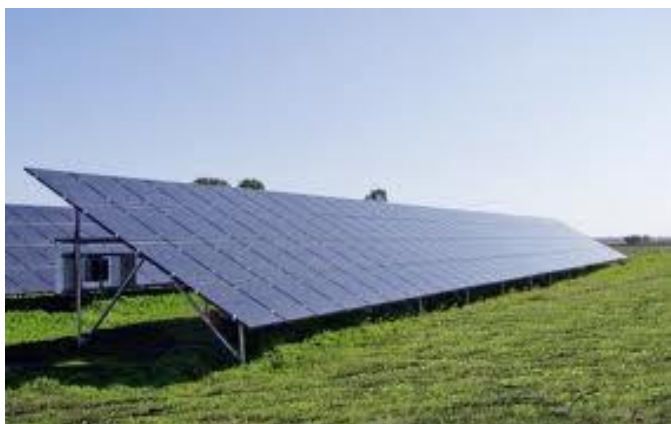
Impianto FV isolato
