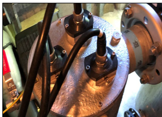
Foto 12: serbatoio Carcale, impianto UV a 3 lampade
