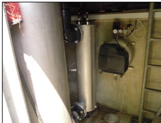
Foto 10: serbatoio Carcale impianto UV
