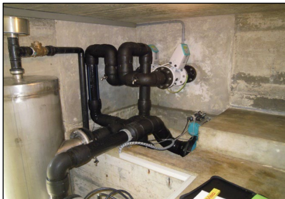
Foto 9: serbatoio Carcale, condotte in entrata
