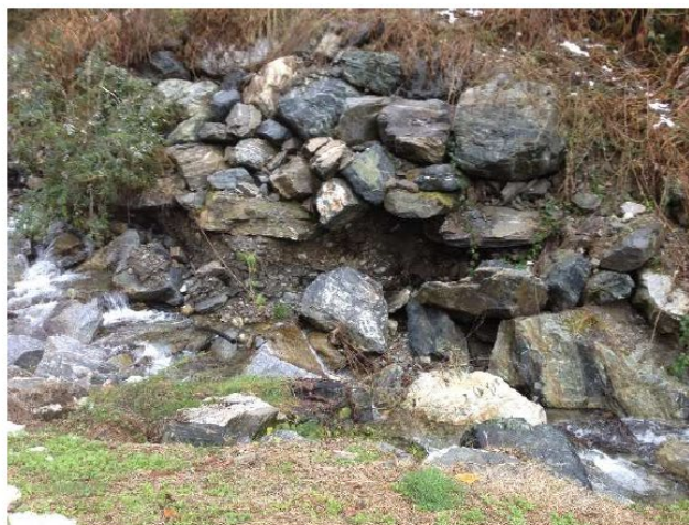
FOTO 2 Erosione materiale al piede della frana
