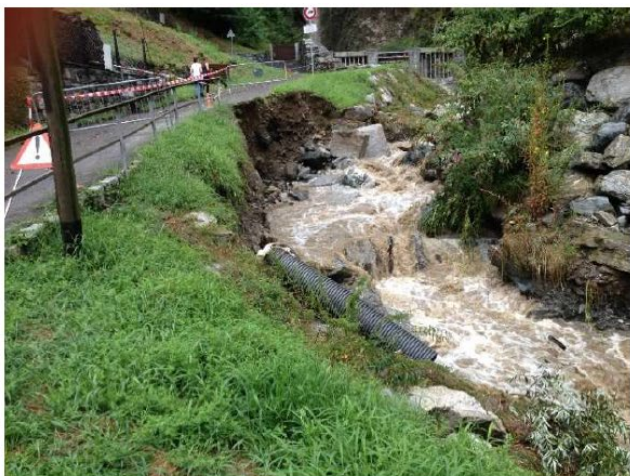
FOTO 1 Erosione campo stradale
