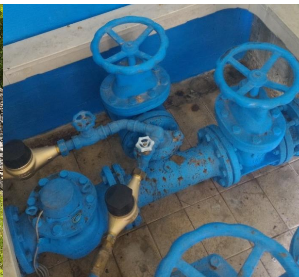
Figura 2 - SE Sasso Fenduto: armature idrauliche
