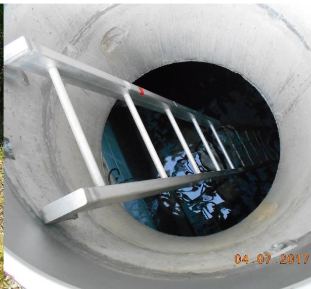
Figura 4 - Scala di discesa vasca di accumulo
