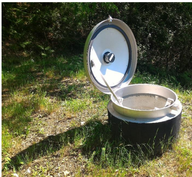
Figura 3 - Accesso vasca di accumulo
