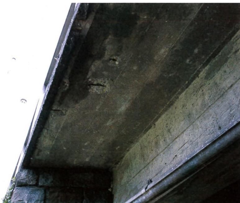
Figura 3: Danni locali con ferri esposti e zone piantane barriera deteriorati
