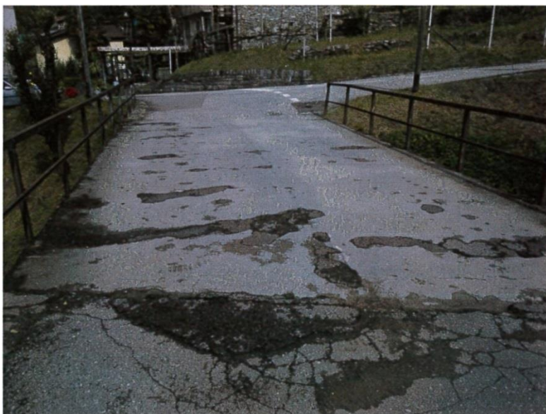
Figura 2: Piattabanda superiore e raccordi in asfalto danneggiati
