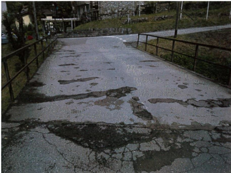
Piattabanda superiore e raccordi in asfalto danneggiati
