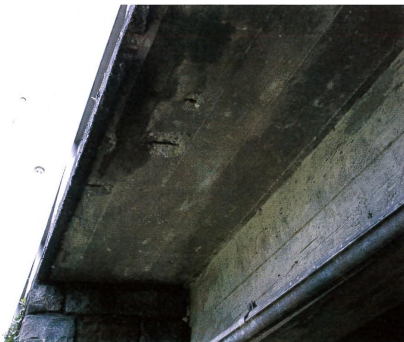
Danni locali con ferri esposti e zone piantane barriera deteriorati
