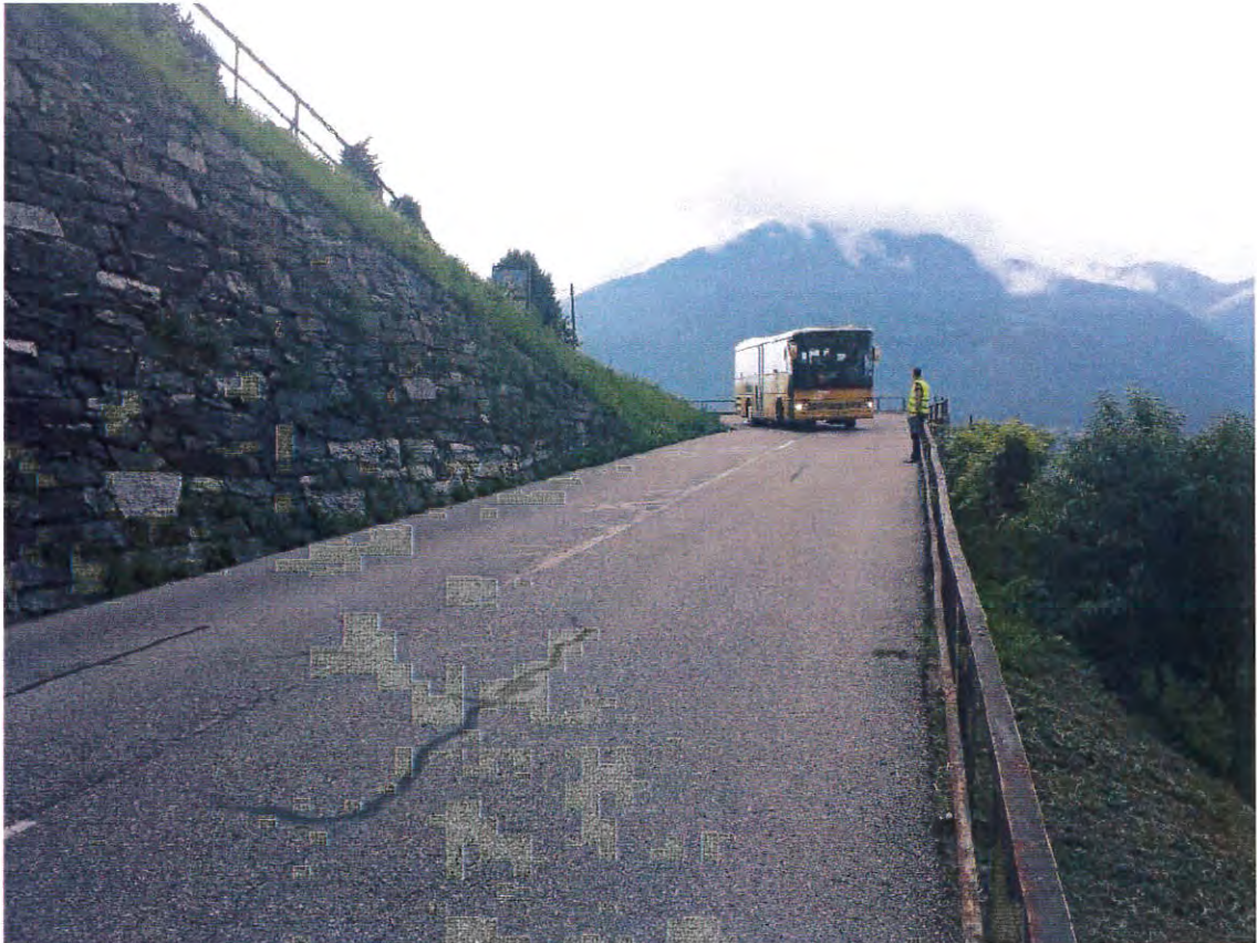
Foto 5 – Tornante a monte, ingombro Autopostale
