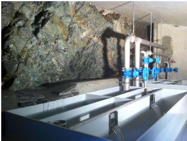
Figura 5 Vasche nuova camera gestione sorgenti e Sorgente 8 che sgorga dalla parete rocciosa
